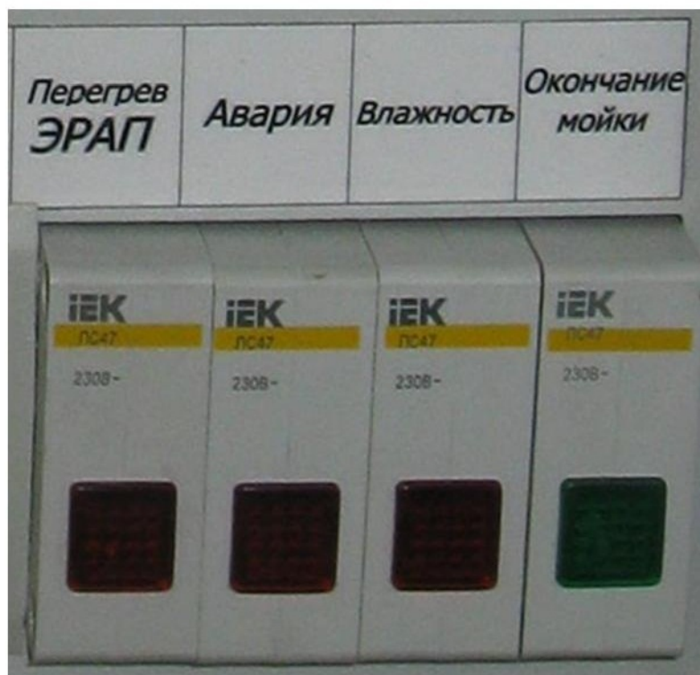
Рис. 5. Сигнальная индикация в щите управления.
